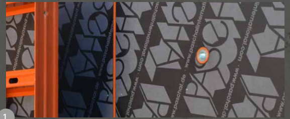
1. Opstilling af forskallingen (udvendig forskalling med LOGO.pro insert/gevind, indvendig forskalling med LOGO.pro muffe)
