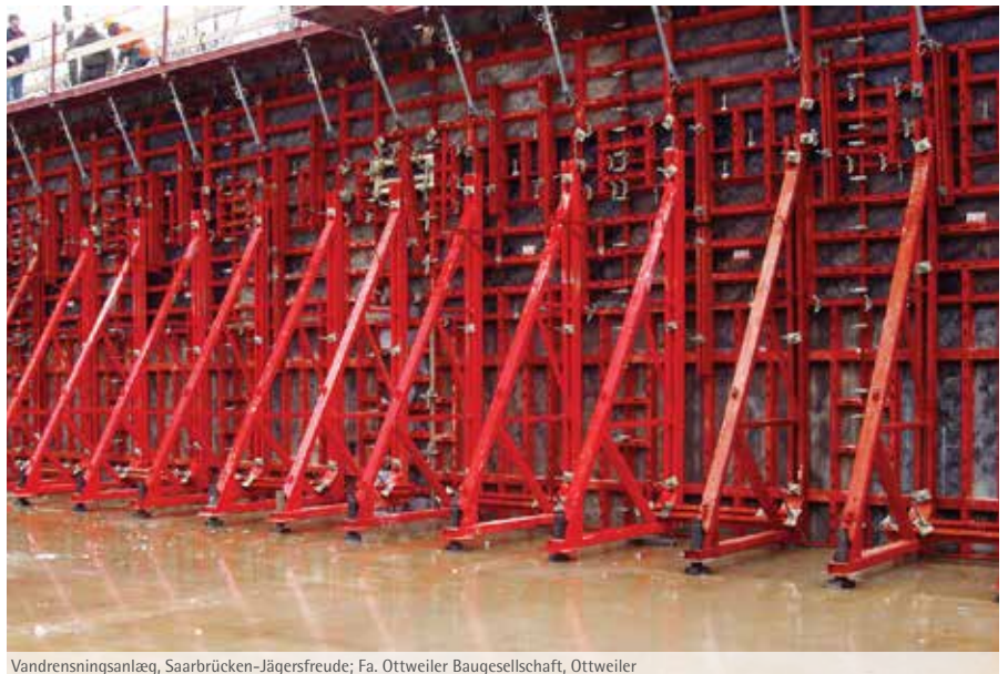
Vandrensingsanlæg, Saarbrücken-Jägersfreude; Fa. Ottweiler Baugesellschaft, Ottweiler
